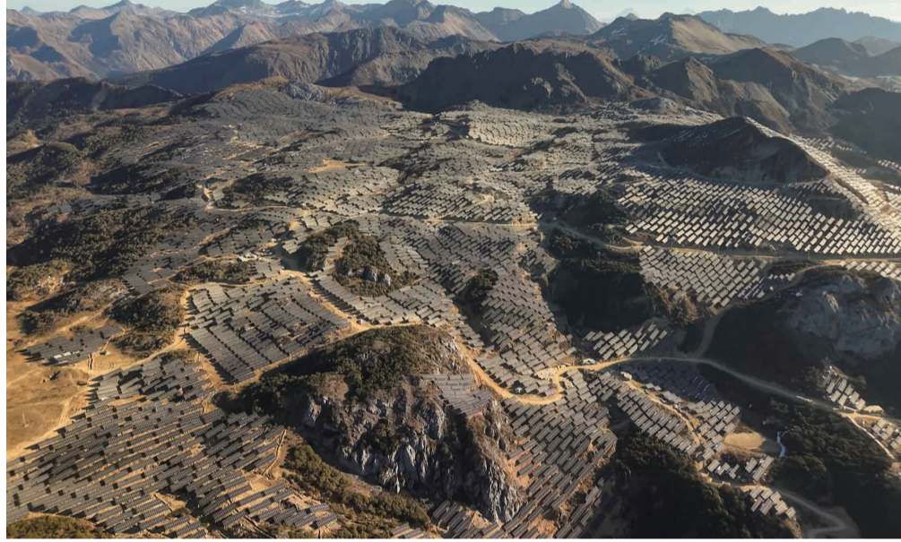
图为砌修塘光伏发电项目(二期) 中南院 提供
