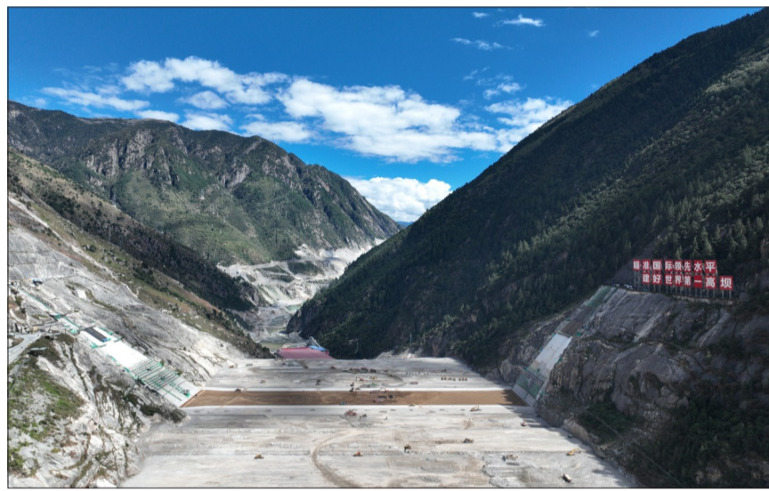
世界第一高坝——双江口水电站大坝填筑现场 水电七局 提供
