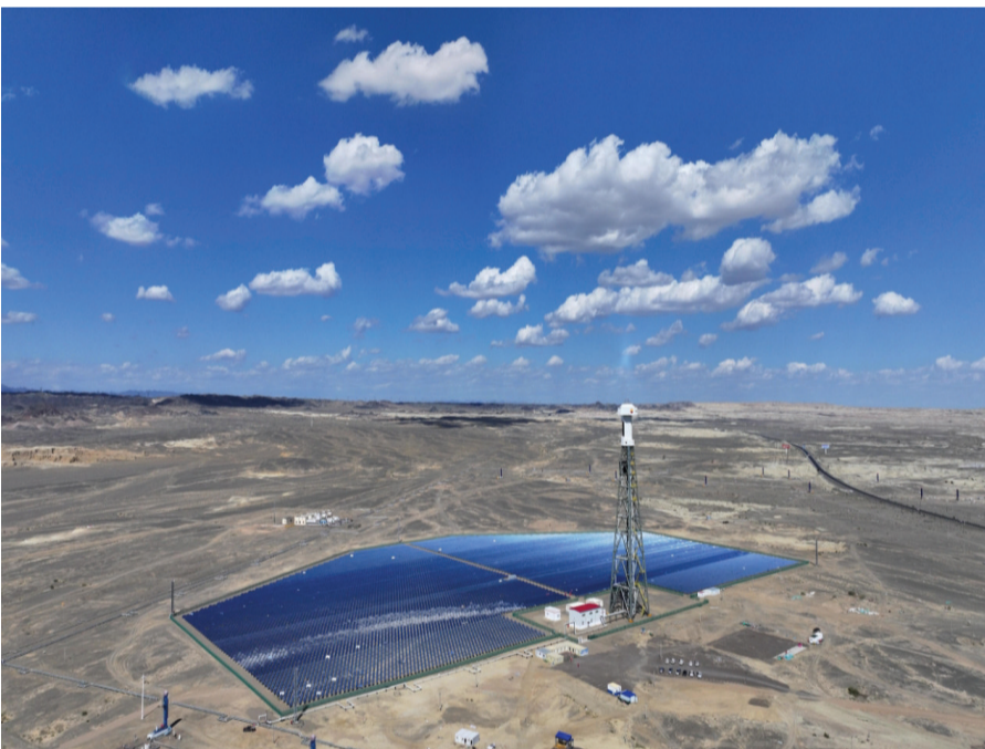
全球首个超稠油开采塔式光热替代示范项目 山东电建三公司 提供
